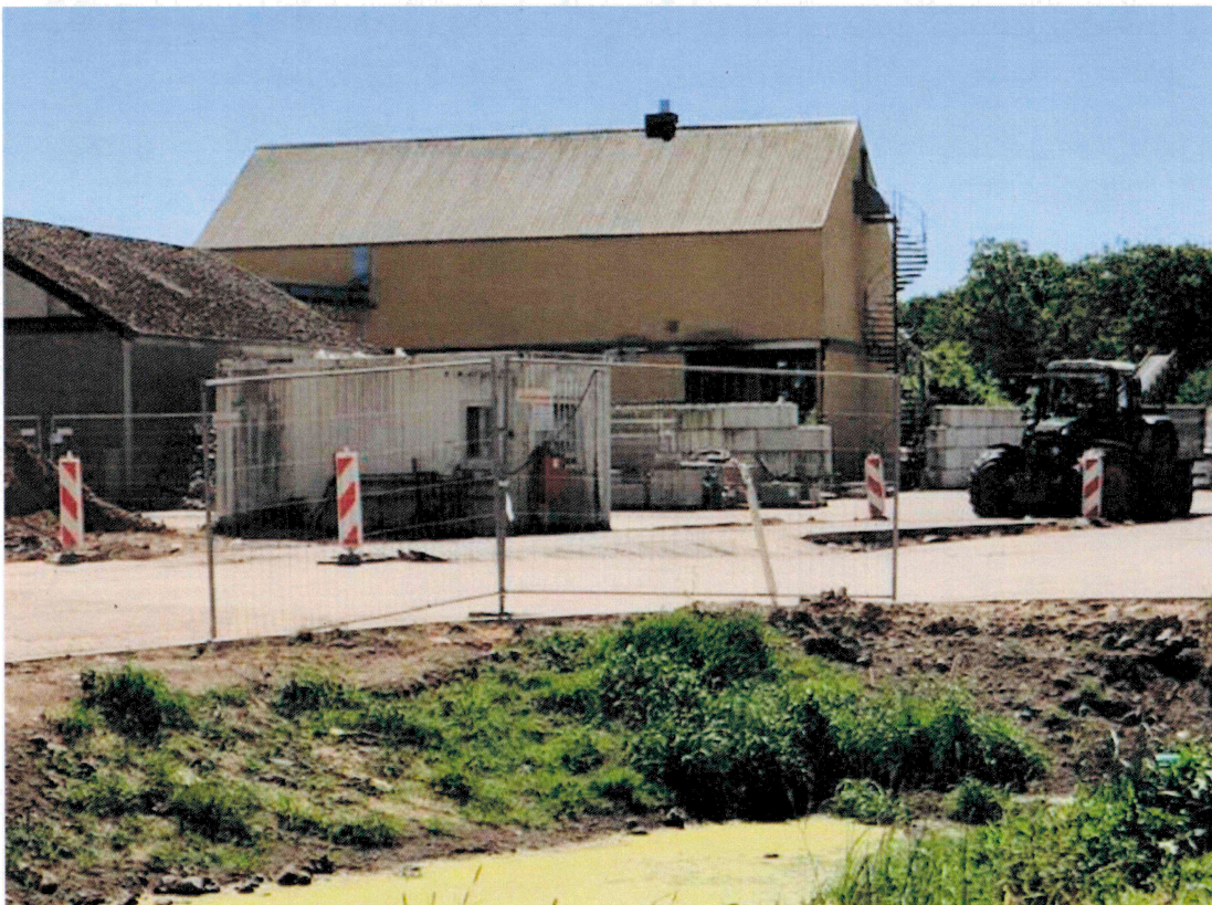
Abb. 6: Lagerhalle, Ersatzbau geplant
