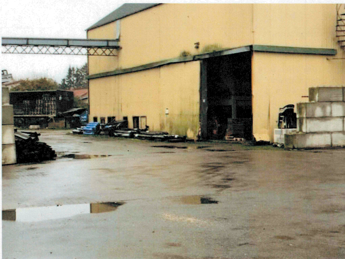
Abb. 7: Lagerhalle, Ersatzbau geplant
